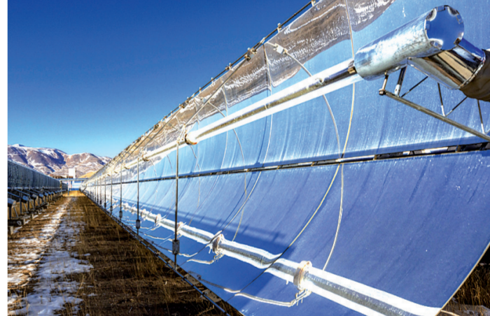
这是中扎县城集中供暖项目太阳能集热场局部(1月6日摄)。
